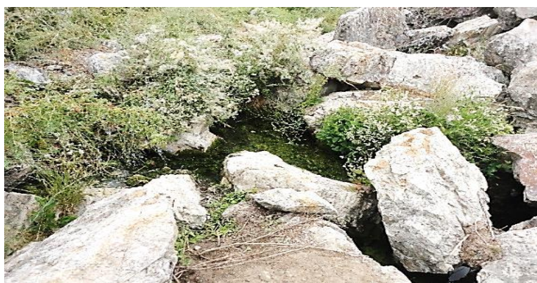
Рисунок 4 - Выход фильтрационных вод из -под дренажной призмы
