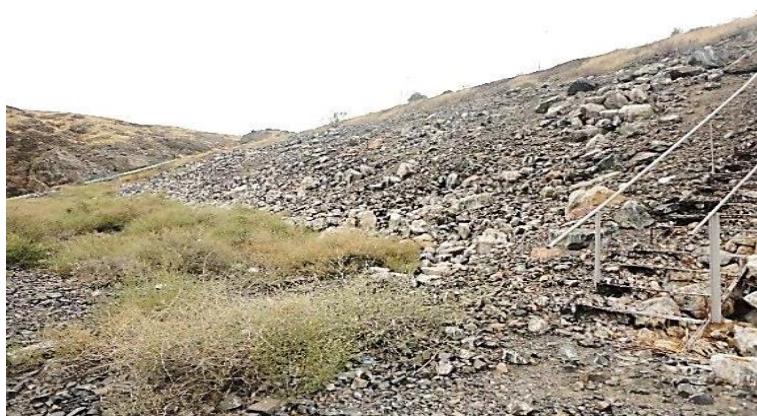
Рисунок 3 - Состояние низового откоса плотины
